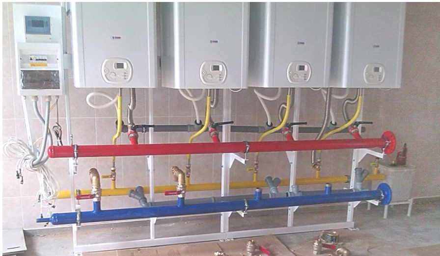
*Собственные фото (Объекты Промгазоборудование)
