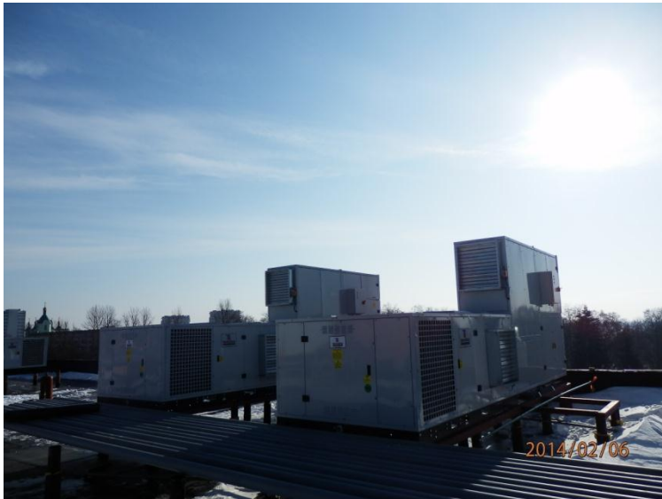
*Собственные фото (Объекты Промгазоборудование)
